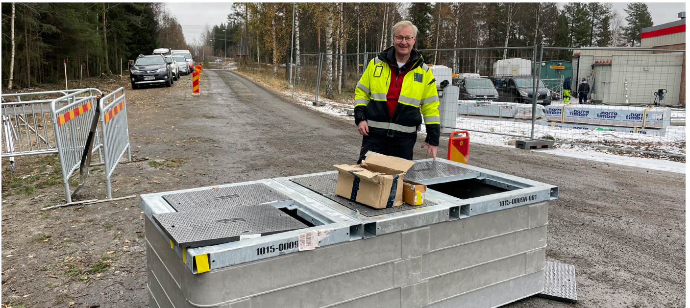
Lennart Rehnström, regional Manager i Melbye, er med på installasjonen av Ultima Connect. Bildet viser fundamentet for ladestasjonens strømforsyning, utstyrt med tre adapterplater.
